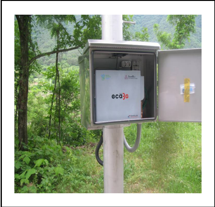
공사설명 7. 후문 적외선 감시카메라 2 설치완료
