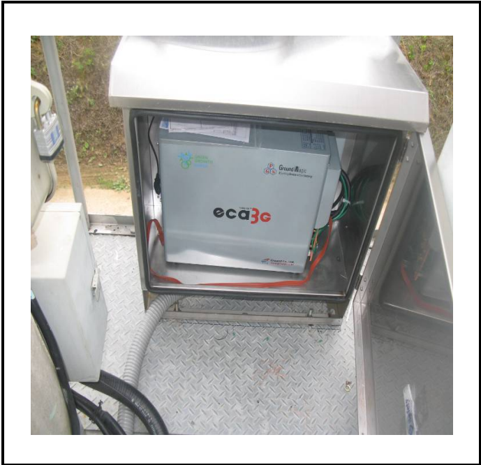
공사설명 18. 방류예경보 제2국 장비설치
