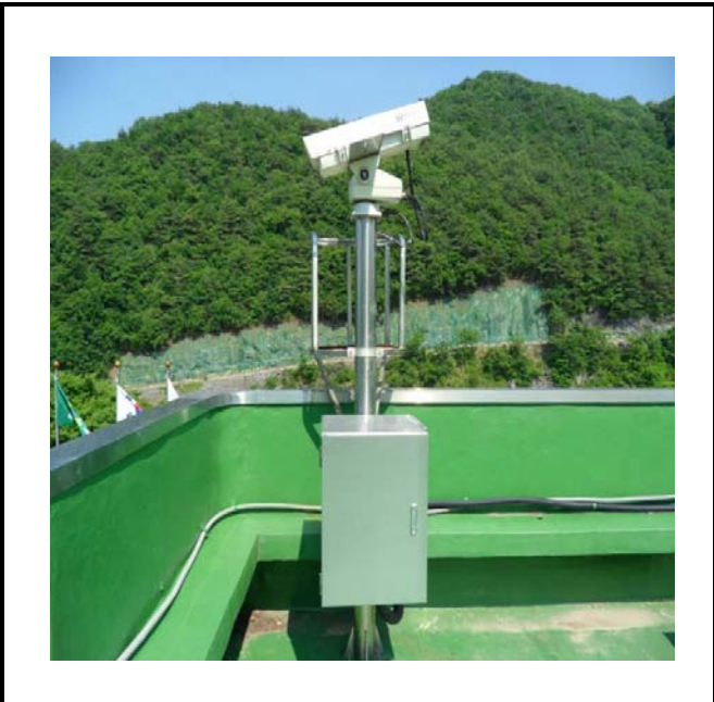
공사설명 2. 사옥 옥상 출입구 감시 카메라
