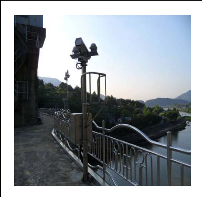
공사설명 6. 공도교 끝 발전방류 감시카메라
