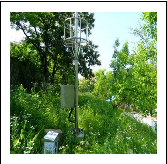
공사설명 3. 옥외 S/S감시 카메라 설치 전
